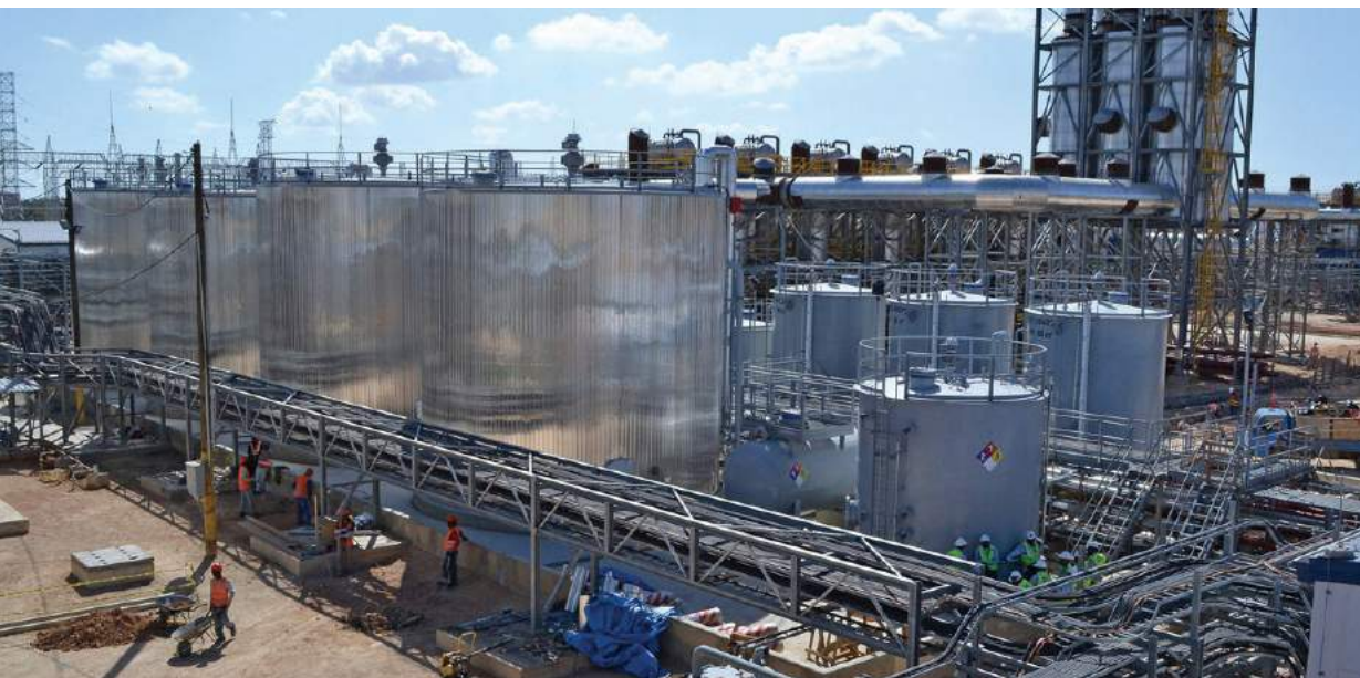
El parque energético de Los Mina es una importante fuente para suplir la energía eléctrica del Gran Santo Domingo.
