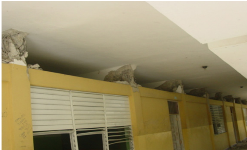
DAÑOS IMPORTANTES EN ESCUELA JOSÉ DUBEAU
