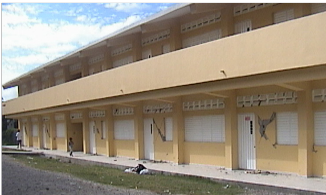
EN ESTA ESCUELA LAS PUERTAS DE ACERO QUEDARON CONDENADAS LUEGO DE SISMO DE PUERTO PLATA Y NO SE PODÍAN ABRIR
