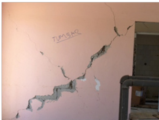
EDIFICACIÓN ESCOLAR DAÑADA
